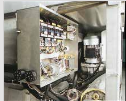
Cuadro eléctrico LP-67
